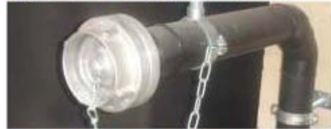
Absauganschluss aussen am Gebäude
