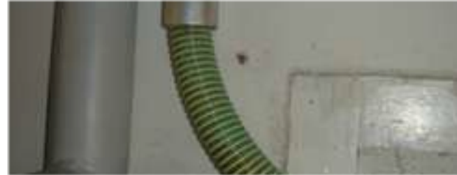
Autom. Transport per Rohrleitung in den Tank
